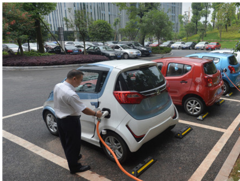
公共停车场及地面充电桩
